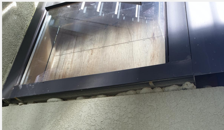
창틀 하부 사춤 부족 및 단열 미시공
