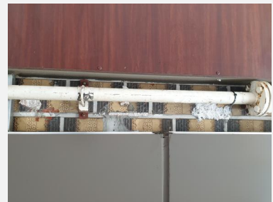
잘못된 시공 사례
