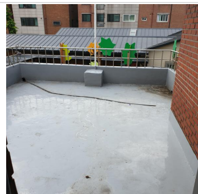
평지붕위 COOL ROOF
