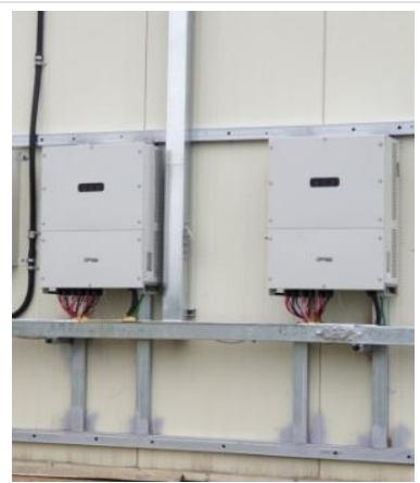
인버터 설치 사례
